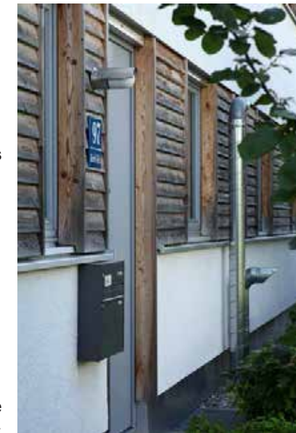
Horizontale Bänder aus Holz gliedern die Fassade im Wechsel mit verputzten Flächen. Die Bänder geben den Fenstern einen ordnenden Rahmen, in den sie frei gesetzt werden können.
