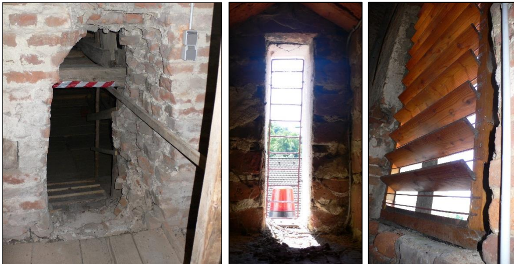
Abb. 6,7,8: Durchflugsöffnung zwischen Turm und Dachstuhl, vergittertes Ausflugsfenster (oberes Fenster der Ostseite) und vergitterte Schallluken.
