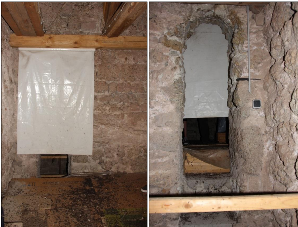
Abb. 10,11: Durchgang zwischen Dachboden und Turm, Ansicht vom Dachboden bzw. Turm aus, die Abdeckung dient der Abdunkelung des Hangplatzes.
